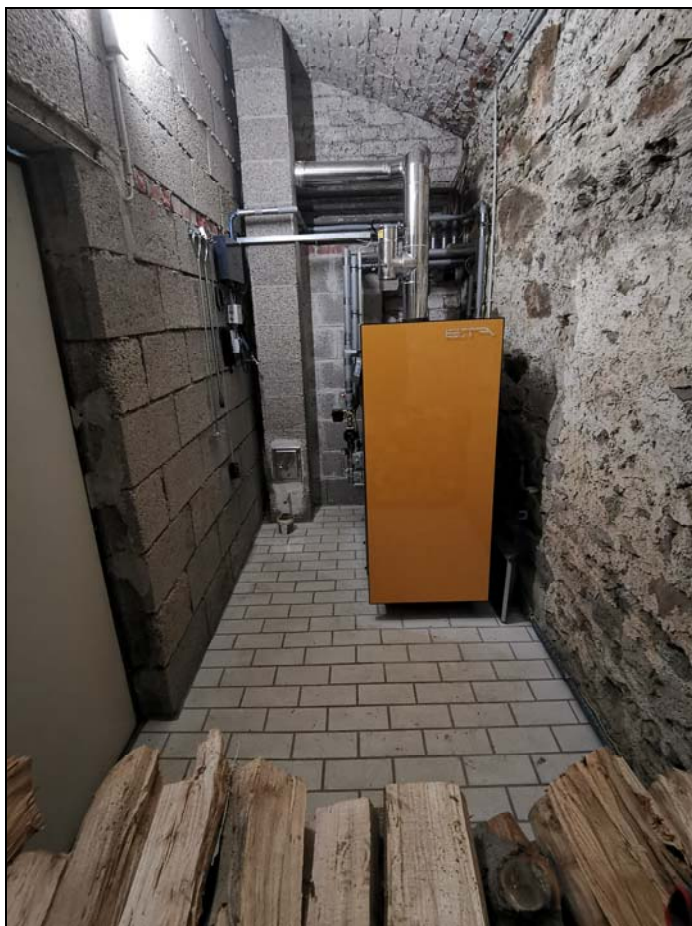
Der neue Stückholzkessel ist Betriebsbereit. Rechts laufen die Leitungen durch die zuvor erstellte Bohrung zum Nachbarkeller
