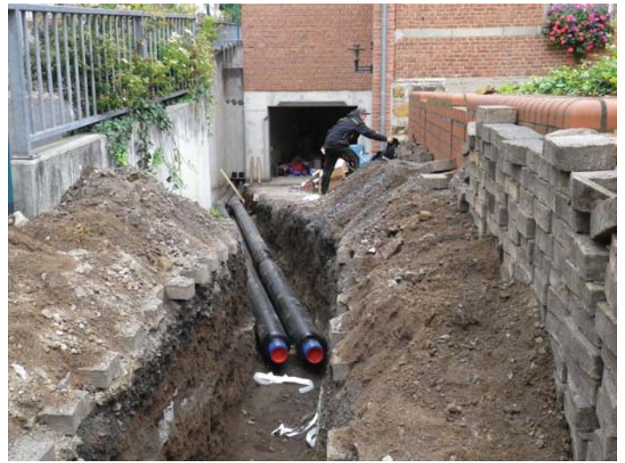
Die durch die Bleichstraße zum Rathaus (Bild) laufenden Wärme-Transportleitungen. Foto: Girmann
